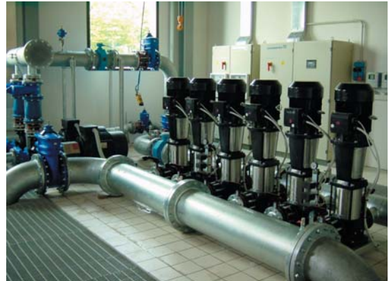
L'impianto nel suo complesso, con in primo piano il gruppo H2000 e le pompe normalizzate NK.
