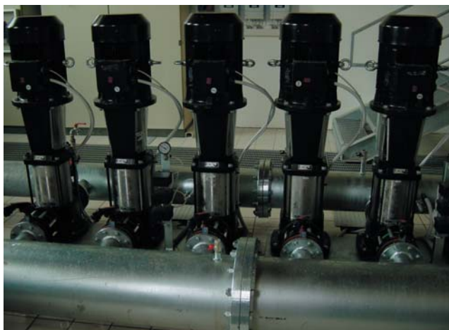
Il gruppo Hydro 2000 composto da sei pompe CR 90
