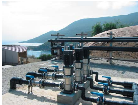
Impianti di captazione: dopo essere passata in due vasche di decantazione, l'acqua viene filtrata e microfiltrata per eliminare tutti i residui microbiologici.
